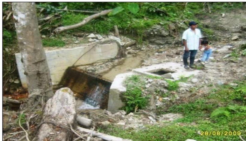
Figura 38. Represa y sistema de captación Resguardo Indígena Las Mercedes, municipio de Rioblanco.
