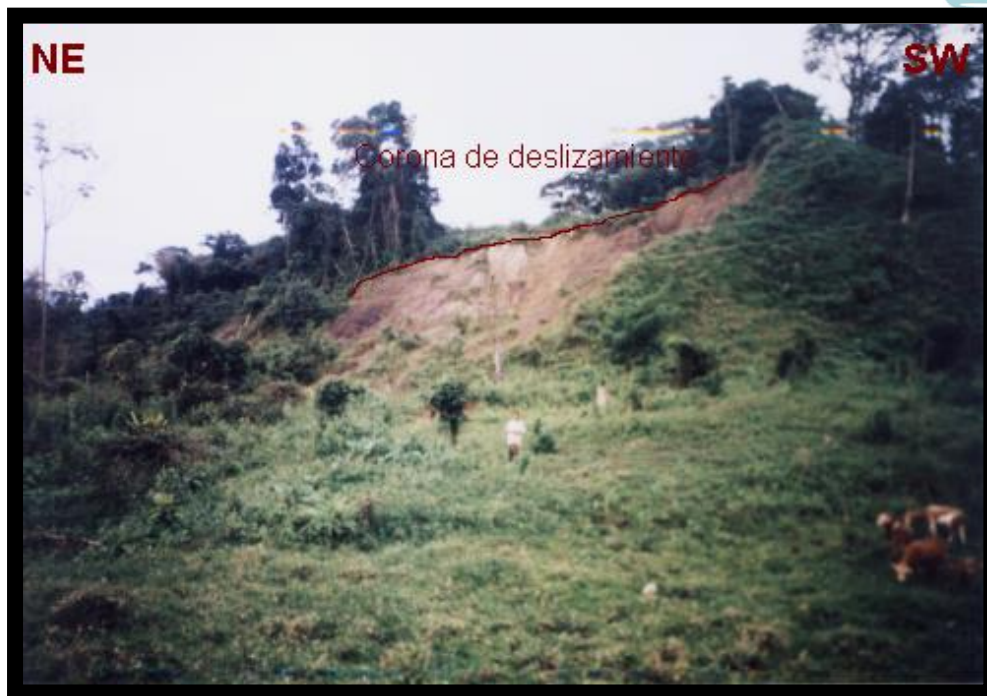
Figura 2.14 Deslizamiento Planar que se Presenta Sobre Coluviones de Remoción. Tomada en la Vereda Torres Alto, Cerca de la Escuela.
