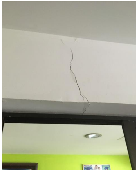
Fotografía 89. Grietas en las paredes de algunas viviendas
