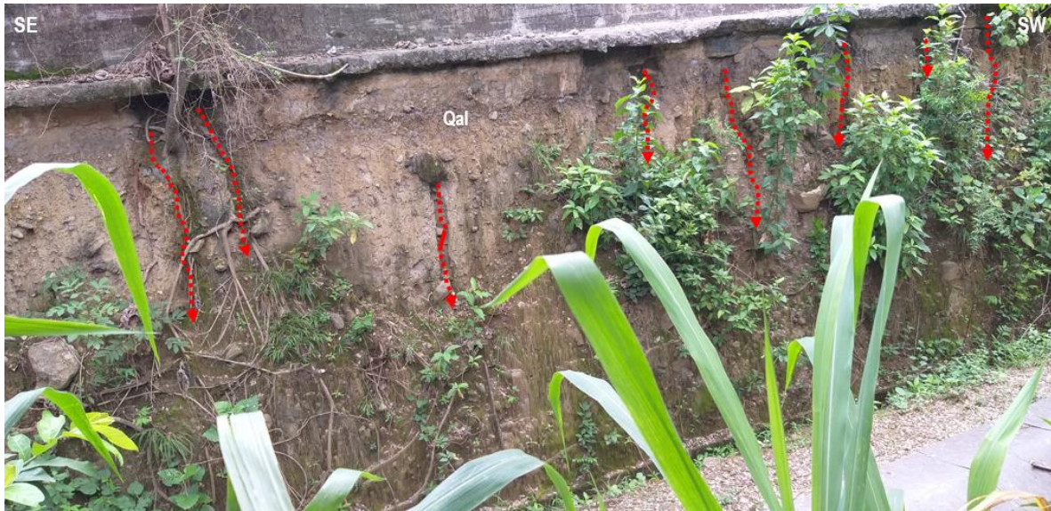
Fotografía 32. Generación de surcos de erosión afectando superficies que conforman la banda transportadora de la mina La Esmeralda en depósitos aluviales (Qal), PM5, título minero 745. Coord. Este 4 766 673; Coord. Norte 2 033 522 Fuente: Elaboración propia.
