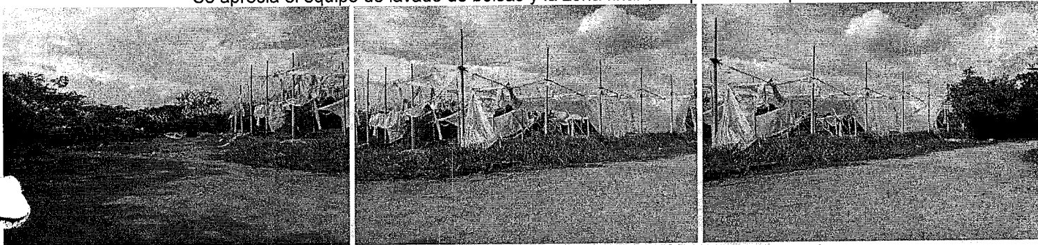
Zona de biotratamiento, se aprecia nuevamente el daño en la cubierta plastica
