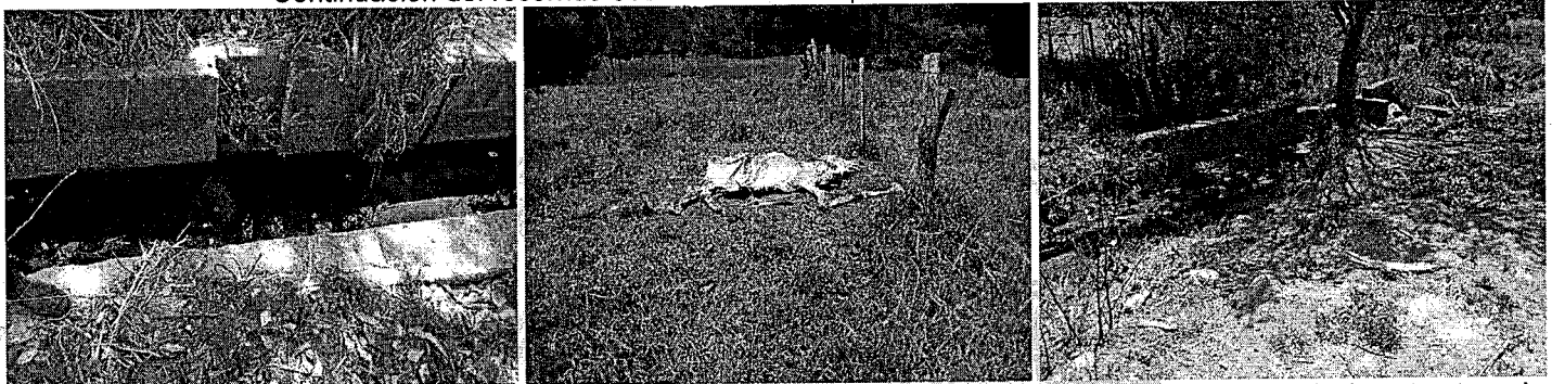
Se aprecia las tomas de agua que se hacen del canal, se observa el animal muerto en cercanía al canal y la estructura de control del agua en la zona
