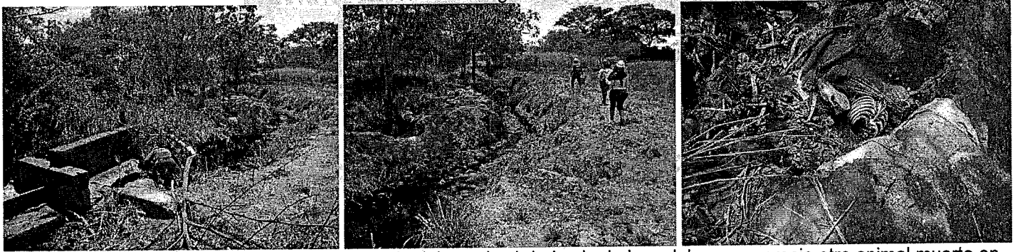
Se aprecia la estructura de control para manejo del canal subderivado de los adobes, se aprecia otro animal muerto en cercanías al canal que conduce el lixiviado tratado
