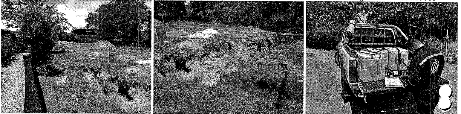
Se observan la excavaciones para destapar la tubería de la zona de descarga de lixiviados sin los adecuados controles y la realización del monitoreo de las aguas subterráneas
