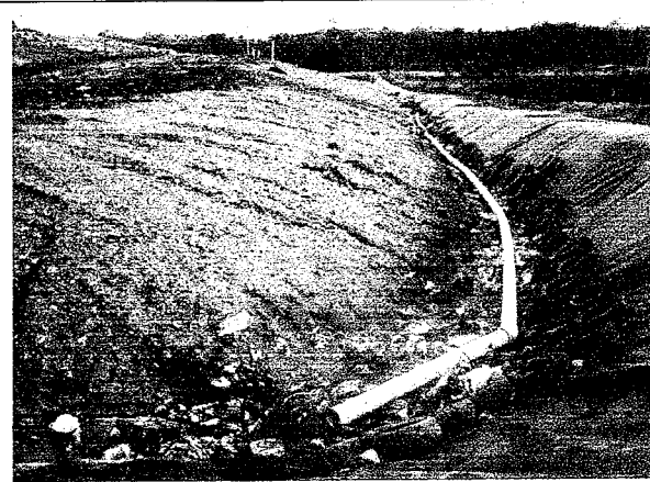
FOTO 6. Pié del relleno en su costado oeste en proceso de llenado, se observa tubo de drenaje, geosintético y llantas acordonadas como protección.
