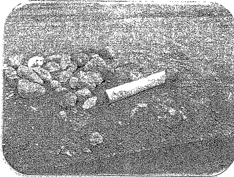
Fotografía No. 5 Tubería retirada por taponamiento en la chimenea 19
