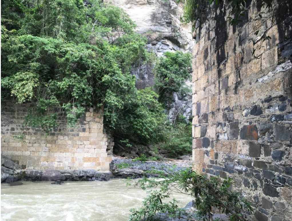
Fotografía 126. Ruinas de Puente Viejo
