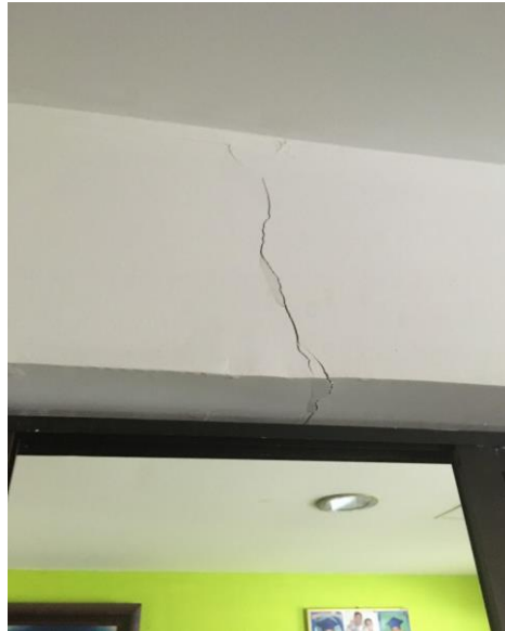
Fotografía 89. Grietas en las paredes de algunas viviendas
