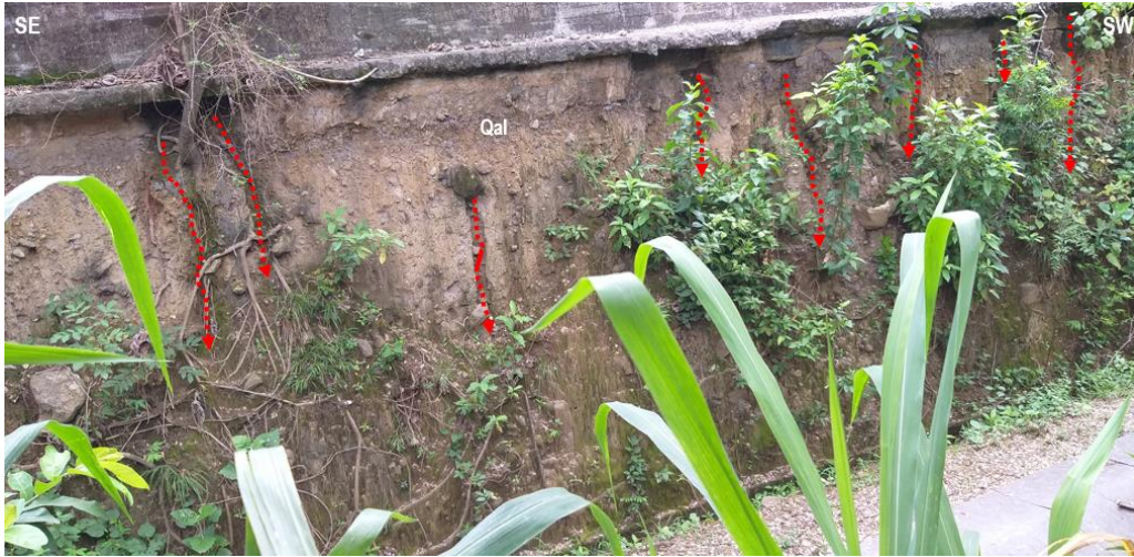
Fotografía 50. Generación de surcos de erosión afectando superficies que conforman la banda transportadora de la mina La Esmeralda en depósitos aluviales (Qal), PM5, título minero 6823. Coord. Este 4 766 673; Coord. Norte 2 033 522 Fuente: Elaboración Propia
