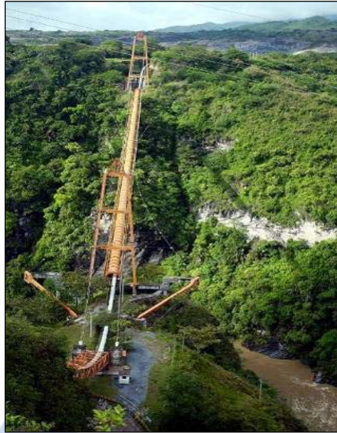
Foto 5.4. Infraestructura existente. Cinta transportadora tubular (Banda - Mina)
