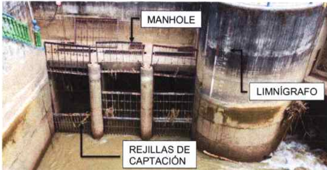
Figura 27. Vista frontal de la Captación.
