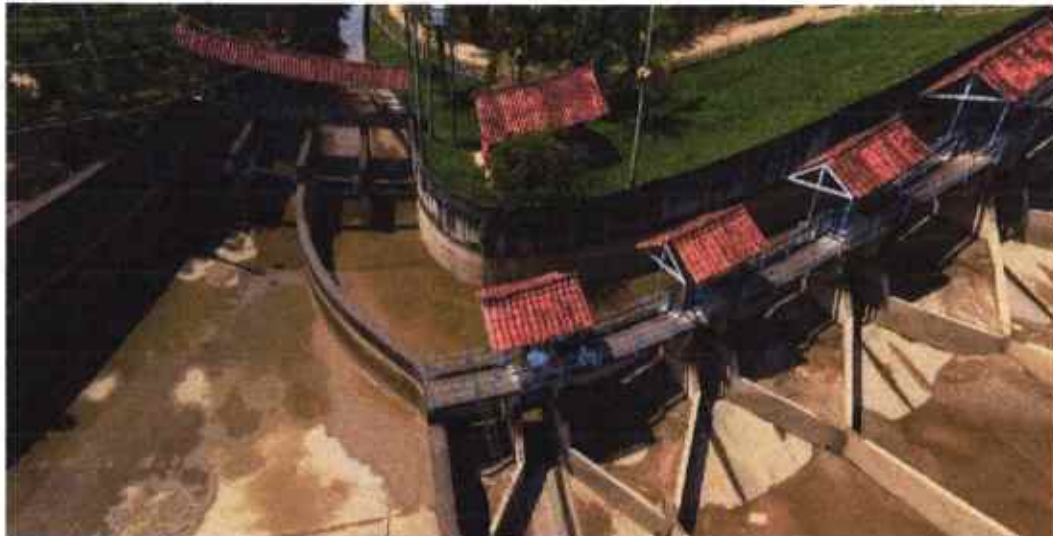
Figura 45. Compuertas de acceso DESARENADOR CUCUANA - USOCOELLO.
