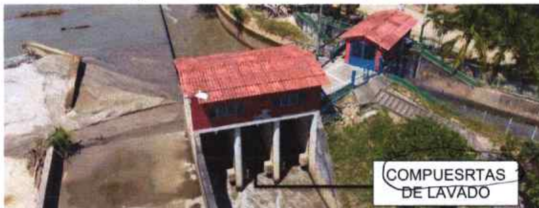
Figura 30. Vista de lavado en la Captación.
