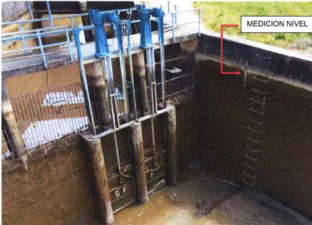
Figura 48. Chequeo de apertura de compuertas de lavado.
