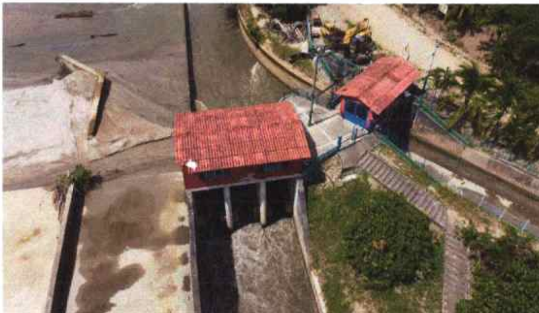
Figura 40. Compuertas de lavado Captación CUCUANA - USOCOELLO.
